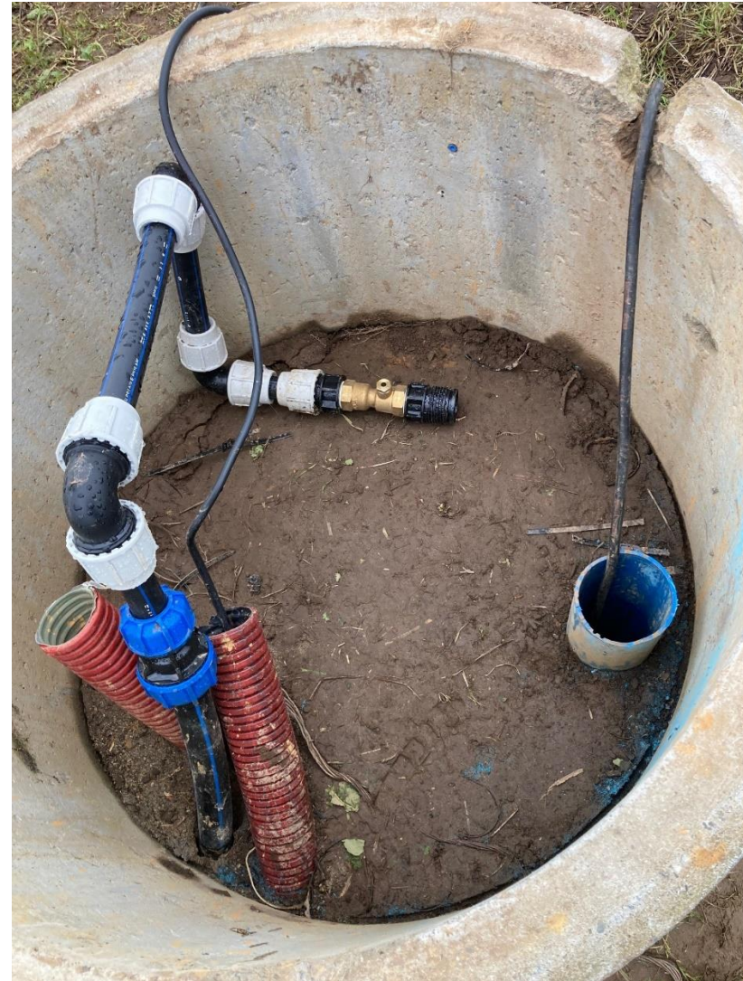
Vue sur l'intérieur du citerneau du forage existant
